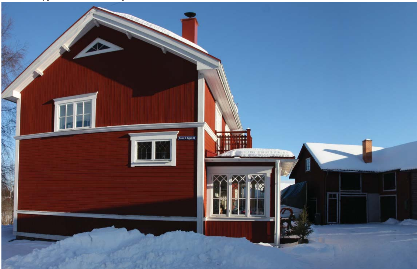
Bonäs Södra bygata 26. De äldsta uthusen är från 1600-talet och är idag angripna av skadeinsekter och hotas av rivning. Foto: Helena von Bergen
