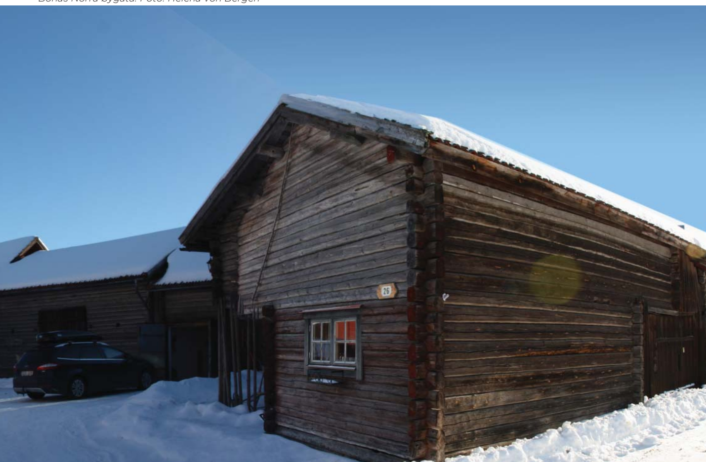
Del av Bonäs Södra bygata 26. Risk finns att fler äldre byggnader kan vara i farozonen för liknande insektsangrepp.
